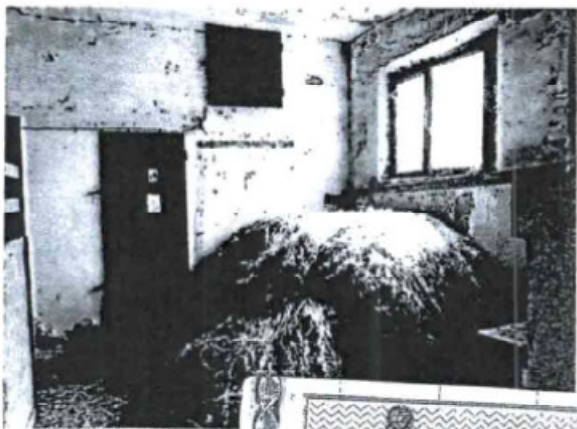
Vista deposito P.T.
